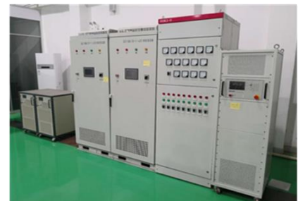
电池储能并网控制系统
